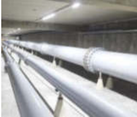
Abbildung 11: Rohrleitungsgebäude mit Mischstrecke
