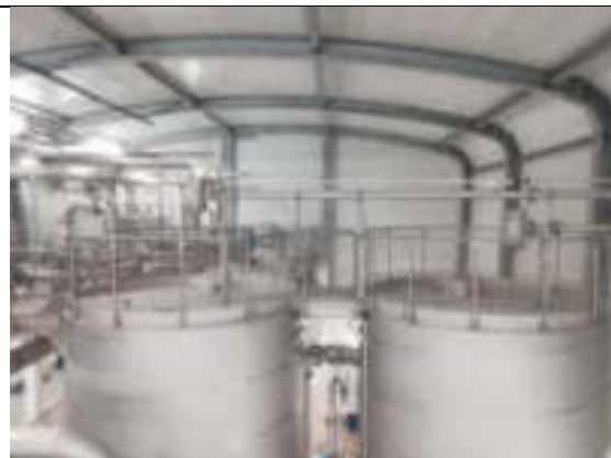
Abbildung 41: Reinwasserbehälter und Flachbettbelüfter
