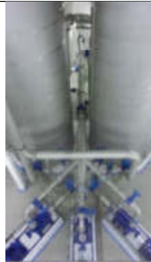
Abbildung 39: Reinwasserbehälter und Förderanlage
