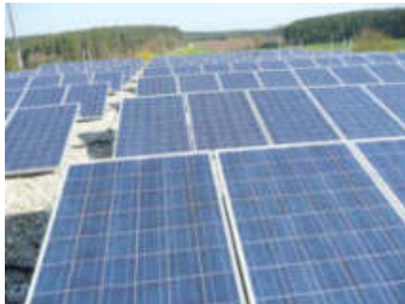
Abbildung 30: Photovoltaikanlage auf dem Dach des Wasserwerks
