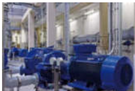
Abbildung 19: Hauptpumpen der RBG
