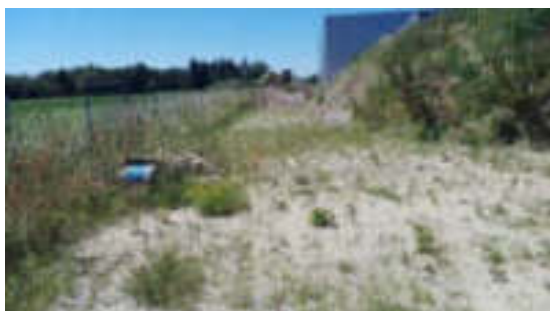
Abbildung 48: Fehlende Anpassung der Gebäudeanböschung
