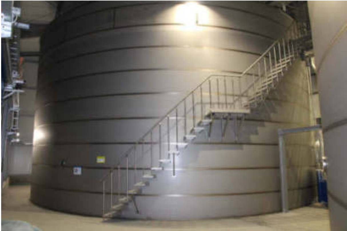
Abbildung 23: Edelstahltank HB Arberg neu
