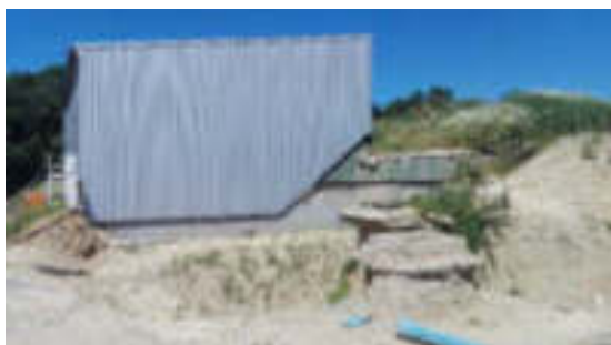
Abbildung 49: Ausstehende Restbauarbeiten im Außenbereich am HB 6.000
